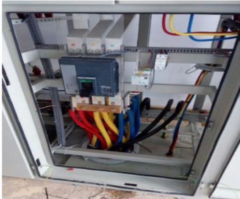
• القاطع الخاص بالمبنى
